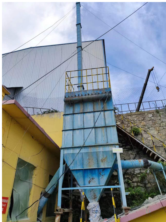
鄂破除尘器 (DA001)
