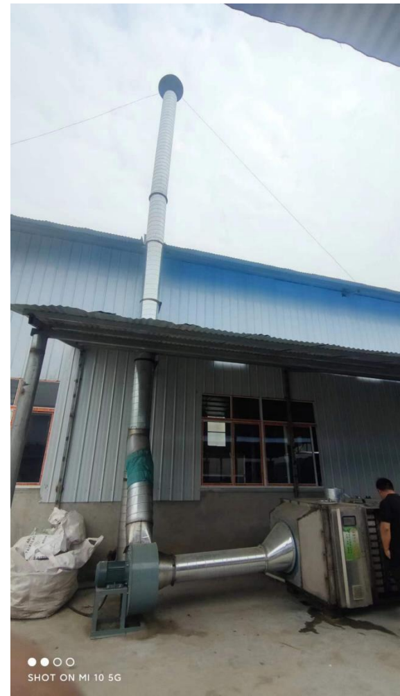
DA003 水洗塔+UV 光氧+活性炭吸附+15m 高排气筒
