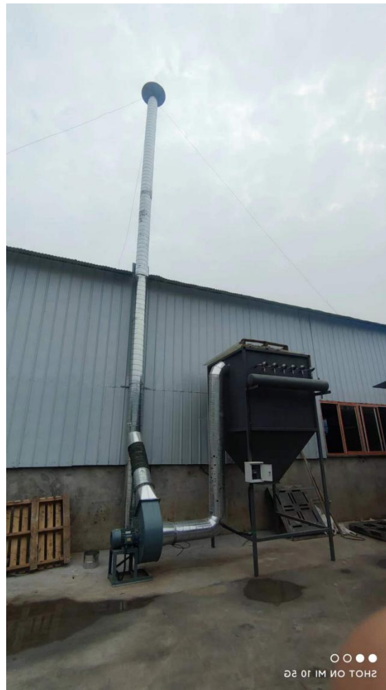
DA002 袋式除尘器+15m 高排气筒
