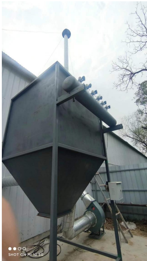
DA001 袋式除尘器+15m 高排气筒
